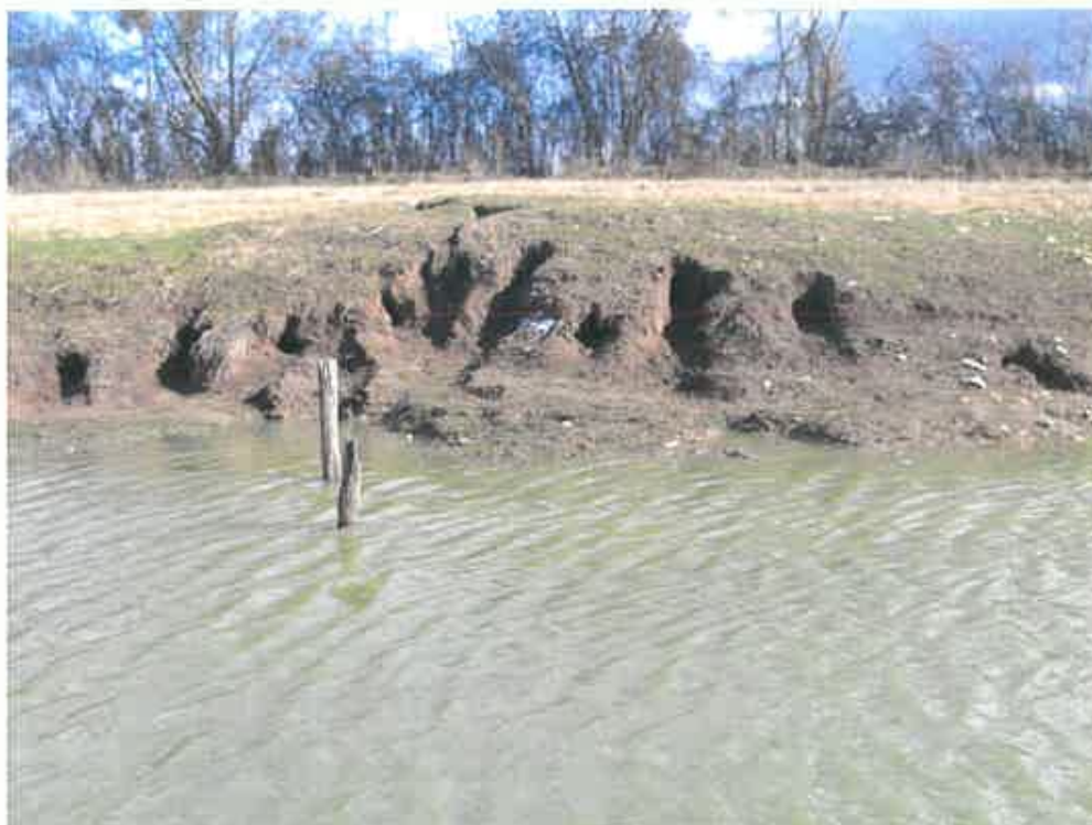
Dégâts de Ragondins sur berges, FDC18
