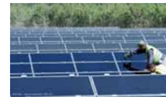
Centrale photovoltaïque de Gabardan (40)
