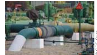
Site de stockage de gaz naturel d'Etrez (01)
