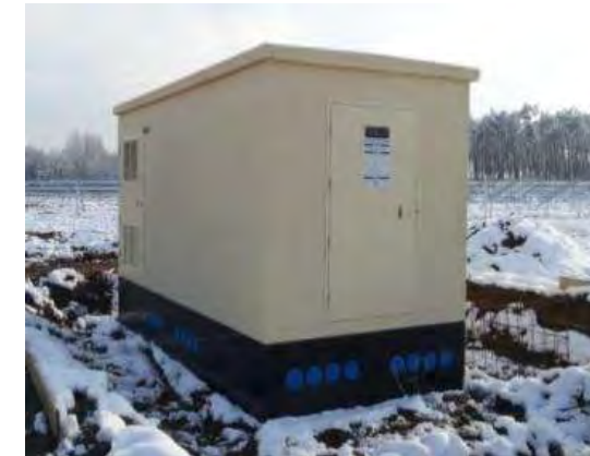
Photo 114 : Exemple de poste de livraison
