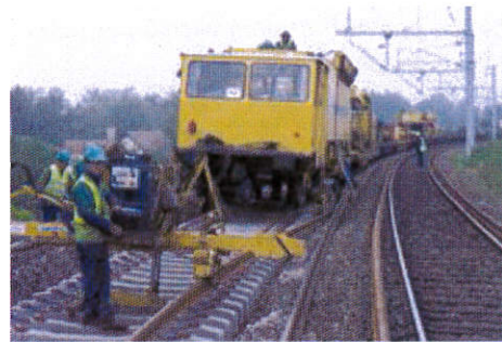
Longs Rails soudés sur traverses béton
