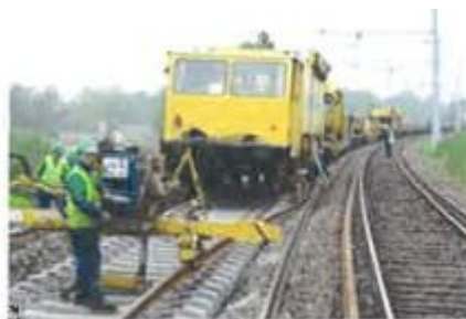
Longs Rails soudés sur traverses béton
