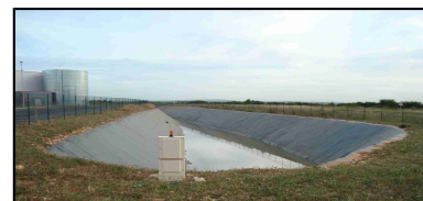
Bassin de confinement 2650 m 3
