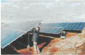
La semaine dernière à Sainte-Hilaire, en Médoc, un incendie a détruit 20 000 panneaux solaires.
